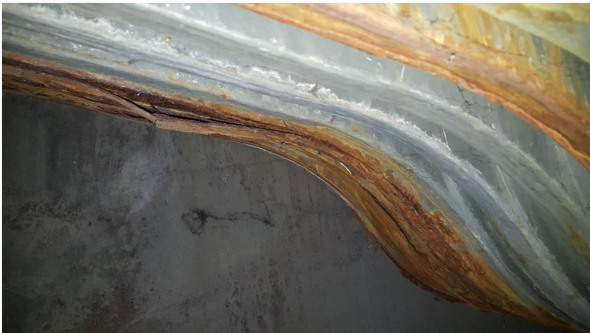
1. ábra Leveles rozsda a lánccsatornában
