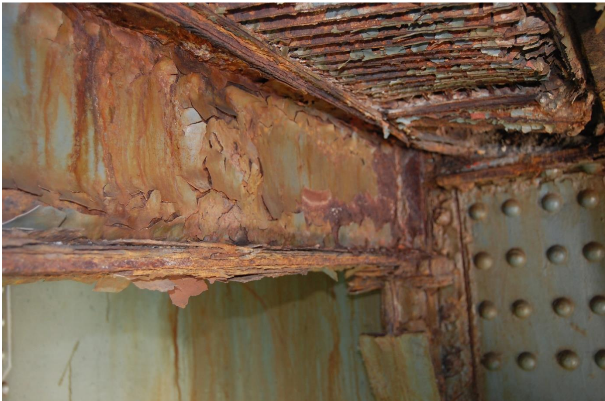
2. ábra Szélső hossztartó súlyos korróziós károsodása (POVIX HÍD Kft. felvétele)
