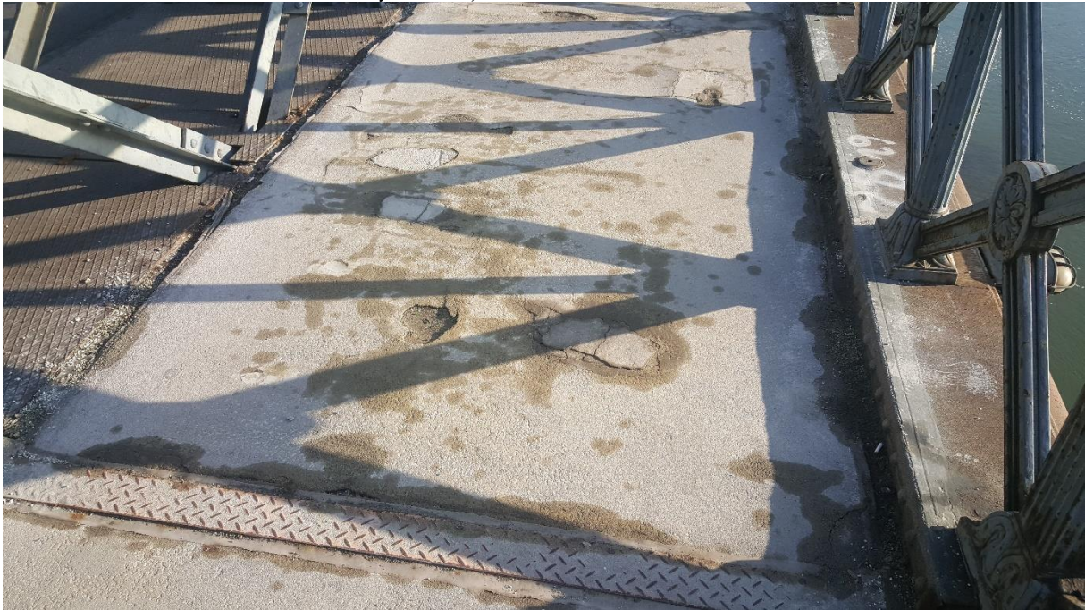
3. ábra Kifolyási oldali járda állapota
